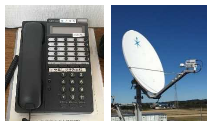
防災電話 パラボラアンテナ
