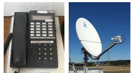
防災電話 パラボラアンテナ
