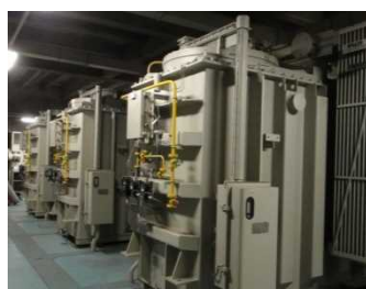
特別高圧受変電設備
