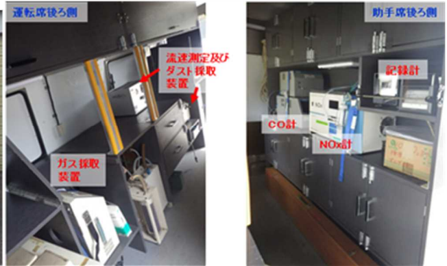
写真2 ばい煙測定車内の様々な測定機器
