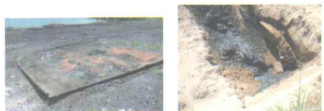
写真2 掘削された鉄板及びグラインダーダスト
