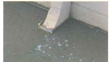
水路の上ガス発生状況
