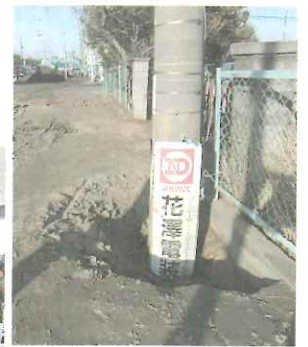
液状化により沈下した電柱 (当日資料より)
