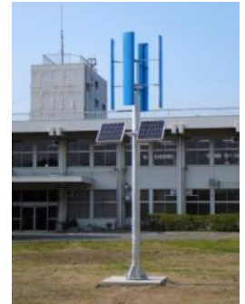
市原地区に設置した小型風力発電装置、太陽光発電パネルも附属しています。
