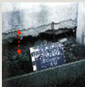
建物の激しい抜け上がり 1972年 浦安南小学校
