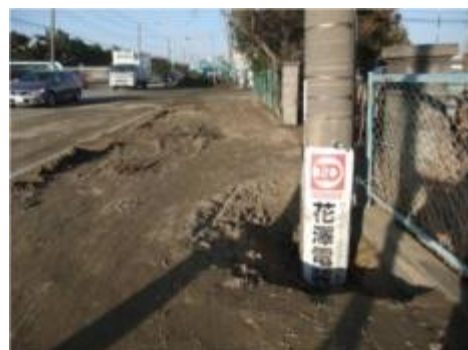
液状化による被害
