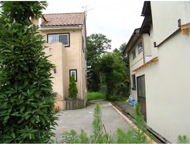
図4 柏崎市長崎（北緯 37 度 23 分 58 秒，東経 138 度 36 分 1 秒付近，沼の北の砂丘最下部では液状化一流動化による構造物被害が多く見られた。ここでは，建物の重みで地中に沈降している。）
