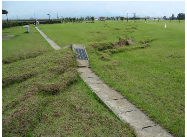
図7 柏崎市橋場町鯖石川改修記念公園での液状化一流動化に伴う地表の変形（北緯 37 度 23 分 29 秒，東経 138 度 34 分 38 秒付近）
