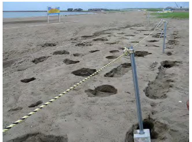
図8 柏崎市西港町みなとまち海浜公園の人工海浜にみられた陥没（北緯 37 度 22 分 17 秒，東経 138 度 32 分 42 秒付近）
