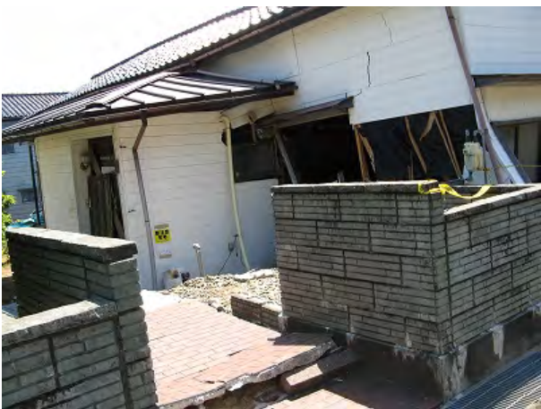
図5 柏崎市山本の造成宅地（北緯 37 度 23 分 38 秒，東経 138 度 35 分 19 秒付近，手前の道路と宅地との境界付近に亀裂がありここから斜面全体が傾斜方向へ動いている。）
