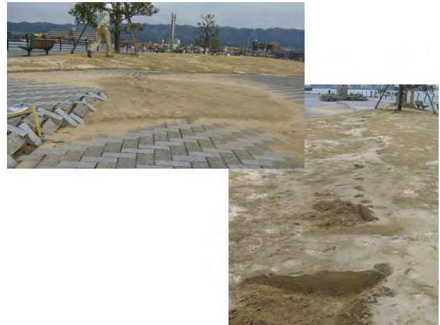
図7 七尾マリンパークでの填砂(護岸の内側が沈下し護岸と埋立層の境界から液状化した砂と地下水が噴出した。)
