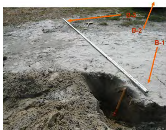
図3 高岡市伏木万葉埠頭埋立地での噴砂(B-1～B-3は貫入試験地点、B-1は噴砂孔、B-3は陥没部分。)
