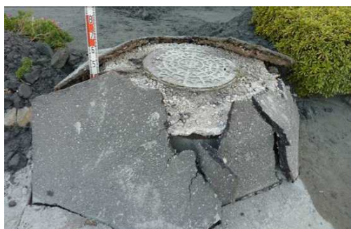
写真20 浦安市日の出 噴砂とマンホールの浮上(3月中旬)。
