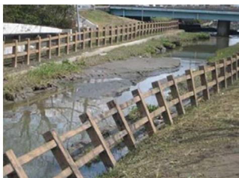
写真29 香取市佐原 十間川護岸のはらみ出しと河床の盛り(3/19)。
