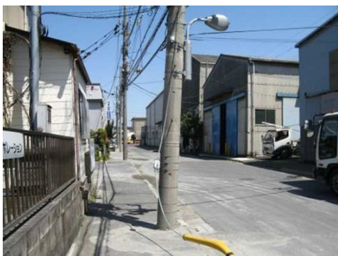
写真19 浦安市鉄鋼団地 電柱の沈下(4/12)。
