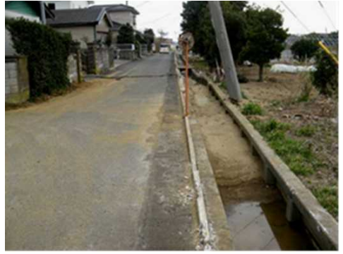
写真35 旭市三川 電柱の脇からの大量の噴砂による水路のダムアップ。水路の変形、道路の変形がみられる。家屋の多くは傾いている(3/20)。
