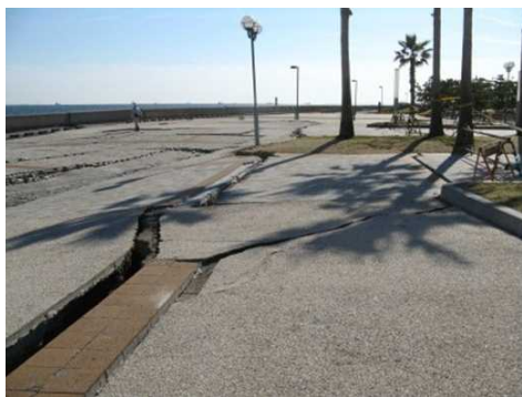
写真23 浦安市日の出 護岸は南東方向へ移動し、亀裂・陥没がみられた(3/18)。
