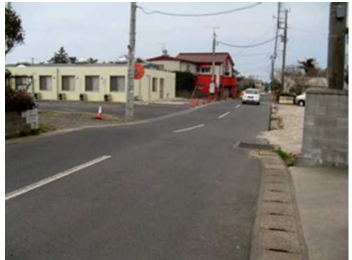
写真37 旭市篠堆 砂鉄採取跡地部分が沈下し、道路には地波がみられる(3/20)。
