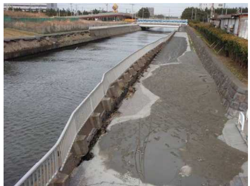
写真26 習志野市芝園 茜浜と海浜霊園の間にある菊田川の水路左岸。左岸側では液状化した噴砂が認められ柵が波打ち水路側に張り出している(3/14)。
