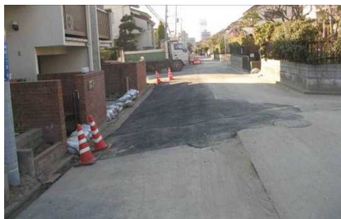
写真12 千葉市美浜区磯辺 家屋が周辺とともに0.6m弱沈降した。今後の降雨での排水不良が懸念される(3/28)。
