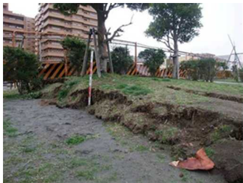
写真27 浦安市明海 落差40cmほどの直線上の急変部が認められた。急変部の上盤側は液状化対策が施してあり変形も小さいが、下盤側(北西方向)は著しい液状化現象が認められる。この急変部は約1kmにわたって追跡できる(3月中旬)。
