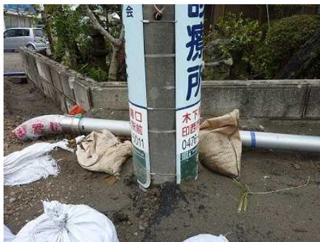
写真28 我孫子市都 大きく沈み込んだ電柱とブロック塀。電柱の際から噴砂が見える(3/22)。
