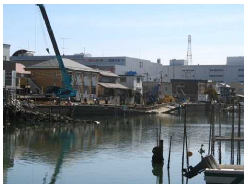
写真25 船橋市日の出 北北東方向の護岸の倒壊(3/18)。
