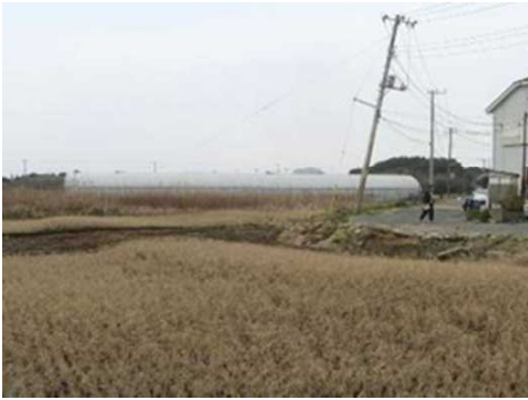
写真34 旭市三川 道路盛土および水田内の変形。液状化—流動化による円弧状地滑りの可能性がある(3/20)。
