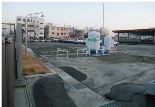
写真10 千葉市美浜区新港 地下タンクの浮上と噴砂(3/12)。
