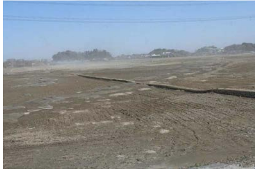
写真33 神崎町神崎新宿 旧河道を埋立てた部分が液状化—流動化し、全体が沈下した。また、旧河道の縁に沿って噴砂が並んだ。東方沖地震時には噴砂はあったが沈下はほとんどみられなかった(3/19)。
