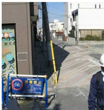
写真18 浦安市入船 道路とともに沈み込んだビル(4/14)。
