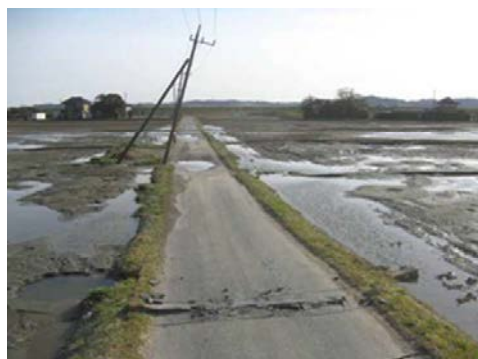
写真31 香取市大倉新田 旧古利根川に沿って電柱の傾き、沈み込みもみられる。沈下の大きいところは2m程度あり、道が水田面以下となっている部分がある(3/19)。
