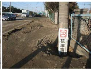
電柱の沈み込みの例
