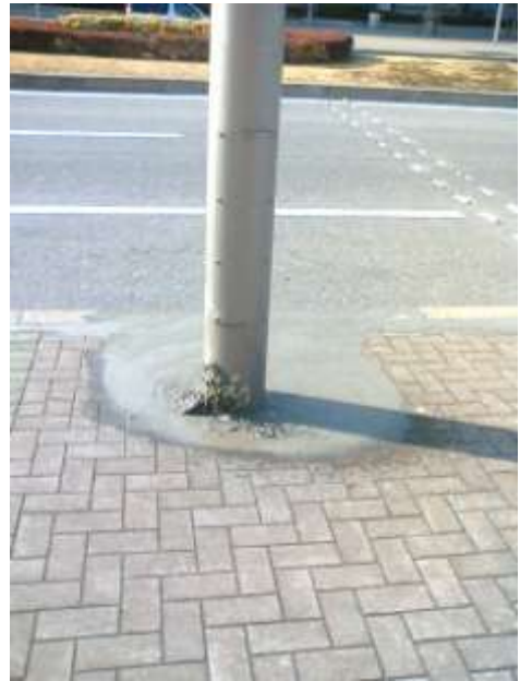
新習志野駅前での液状化－流動化現象 3/11 15時6分頃撮影
