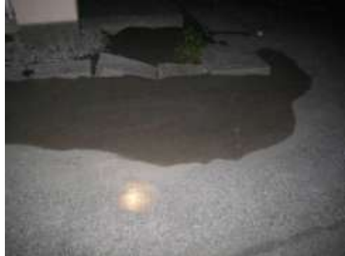
センター稲毛地区内の地質環境インフォメーションバンク棟脇のアスファルト上の新たに噴出した噴砂。同地区水質棟周囲の配管も修復直後の再液状化－流動化により再罹災する(4/12夜撮影)。
