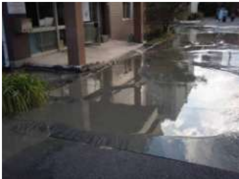
地質環境研究室棟の玄関部分。液状化－流動化により地盤の沈下が起こり、玄関の踊り場が両端の柱で吊られている状態となっている。3/11 15時17分頃撮影。
