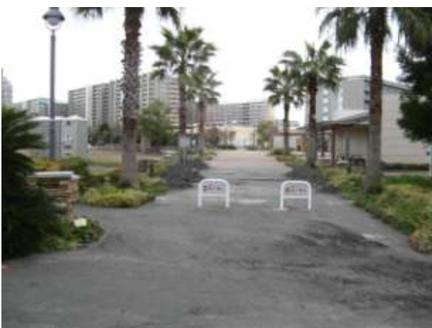
日の出 日の出おひさま公園では入口付近は噴砂が多く、地表面の変形もみられる。入口の門から南へ進むにつれ、噴砂は少なくなり地表面の変形はわずかとなる（Cタイプ）。さらに南では、被害はみられない。
