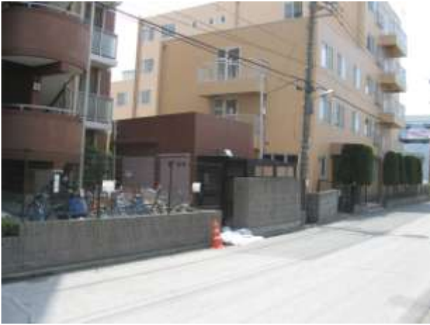
今川 ブロック塀は10～20cm 提訴沈降している。
