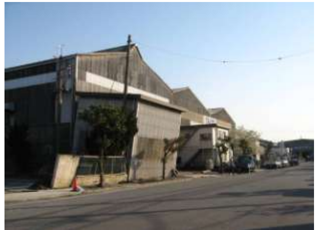
鉄鋼団地 倉庫が大きく傾いている
