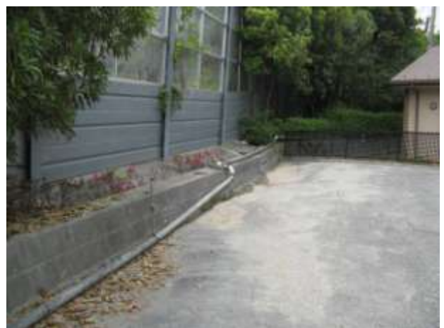
舞浜 左の塀の端で20cm程度沈降した。
