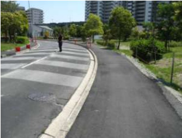
日の出 道路中央が高くなり，両脇が数十 cm 沈下し，その両脇はさらに沈下し，排水ボックスが横向きになった。
