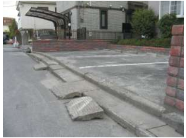
今川 道路わきの戸建て住宅敷地部分は10～20cm程度沈下した。道路わきの排水路は波うっている。
