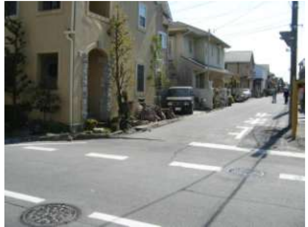
入船 道路面に波うちがみられる。また、戸建て住宅は 20cm 程度沈み込んでいる。
