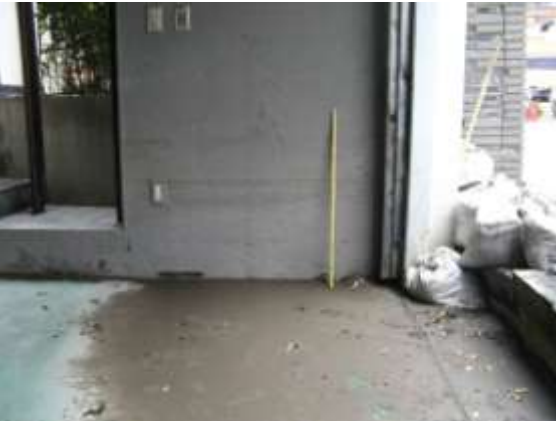
今川 車庫が 30cm 程度沈降した。大量の噴水により床面から 90cm の高さまで水没した。この水位は道路面上約 60cm の水深となったことになる。
