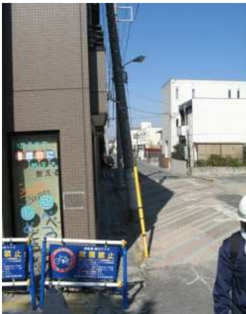
入船 3階建てのビルが 50cm 程度沈降した。周囲の道路もいっしょに沈降し, 電柱は大きく傾いた。
