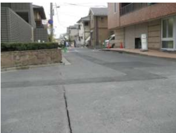
今川 道路と歩道が波打つ。凹凸の落差は20cm程度である。
