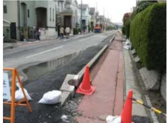
舞浜 道路中央が相対的に高くなり, 両脇が数十 cm 沈下している。両脇の戸建て住宅とレンガ塀は数十 cm 程度沈み込んでいます。電柱は沈降し傾いている。
