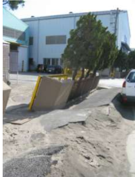
鉄鋼団地 大量の噴砂とコンクリート塀が沈み込み大きく傾いた。
