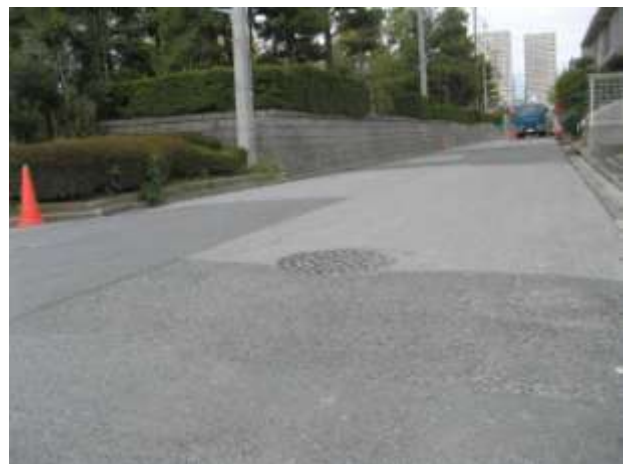
今川 今川記念公園の周囲を囲む盛土の周辺では、その重さにより道路面とともに 20cm 程度沈んでいる。
