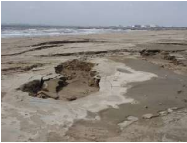
人工の砂浜一帯に噴砂が連続的に認められ、一部には陥没も認められた。
