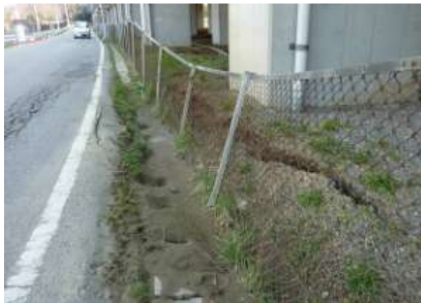
高速道路と側道間の亀裂と噴砂。
