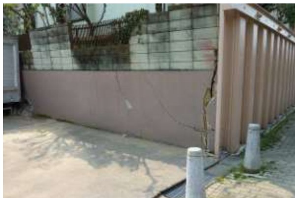
この地域のブロック塀の亀裂。写真左側は高速道路側道, 右側は矢板が打ちこまれた開渠下水道に挟まれた
