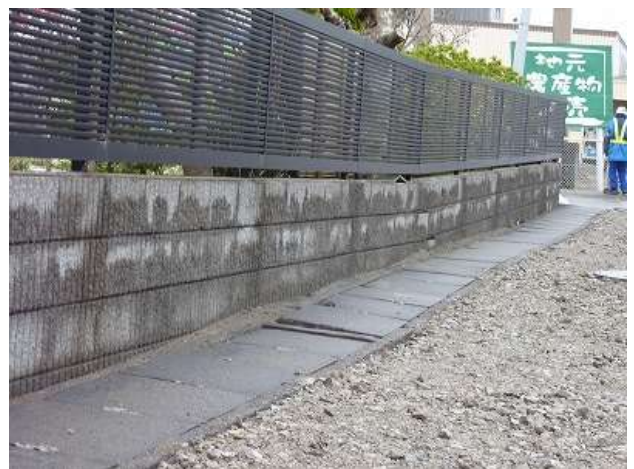
都：ブロック塀沿いの暗渠側溝の蓋波打っている。ブロック塀も写真中央部分が落ち込んでいる。
