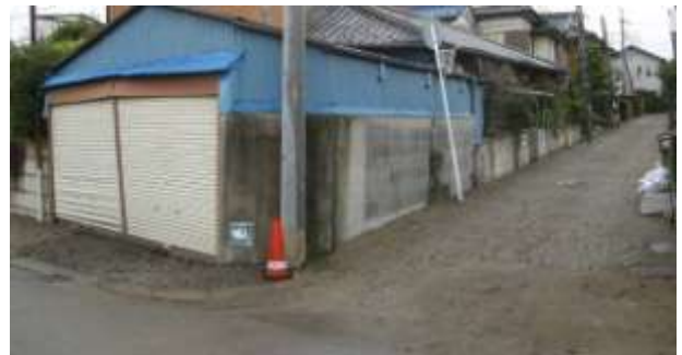
布佐酉町：道路の変形と家屋・塀の傾き。
