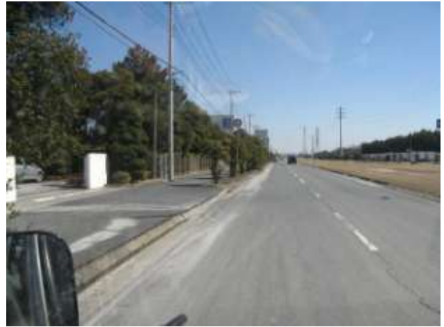
歩道の縁石は道路側（南）へ傾いている。白く見えるのは噴砂。
