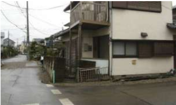
布佐酉町：道路の変形と家屋・塀の傾き・沈み込み。
