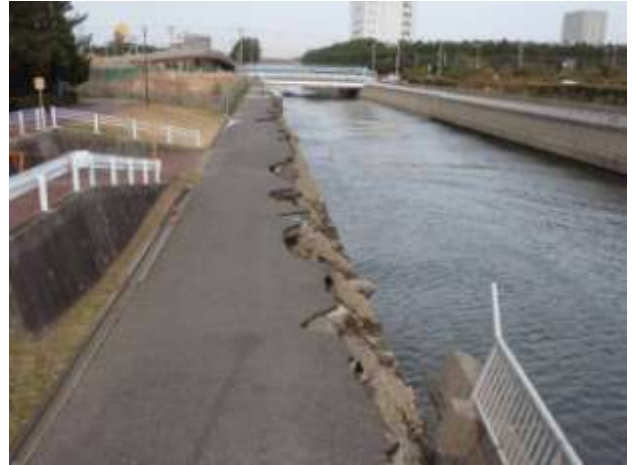
茜浜と海浜霊園の間にある菊田川の水路右岸。右岸では道路が割れ、柵が倒壊している。
