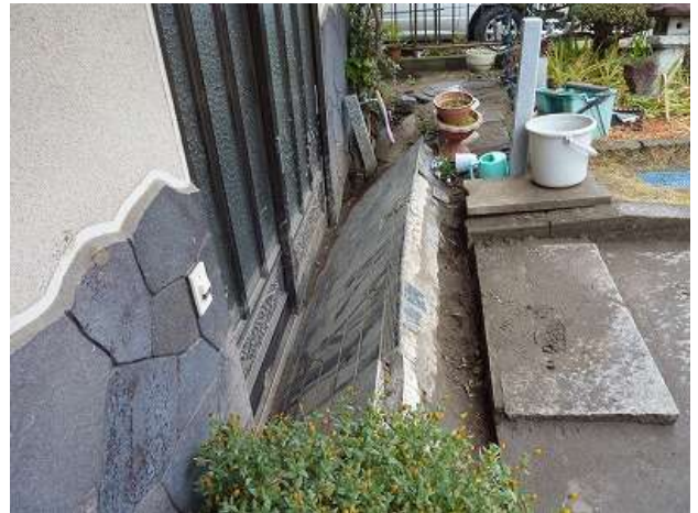
都：家屋の沈下・傾動。敷地（庭）面との相対的な変化が大きく玄関前敷石が大きく家屋側へ落ち込んでいる。
