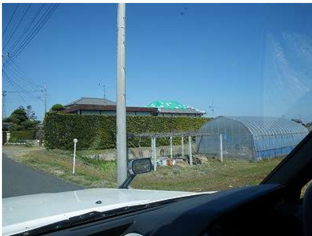
大貫飛地西側の民家、屋根瓦が被害を受けている。
