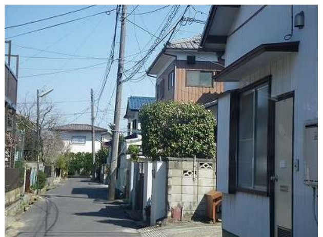
電柱の傾き。手前は右、奥は左へ傾いている。
