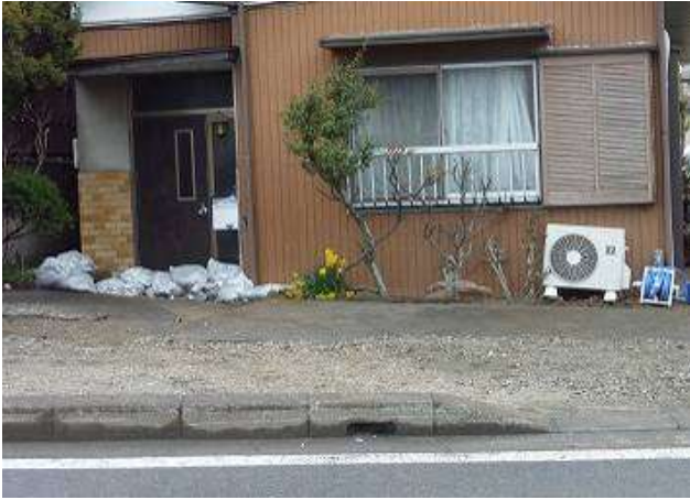
都：家屋の沈み込み・傾動。
