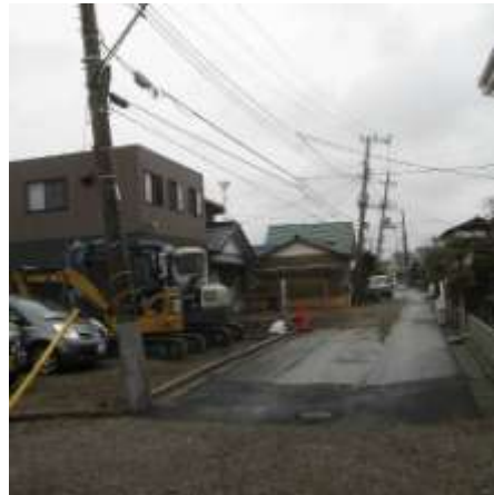
布佐酉町：道路の変形と家屋・塀の傾き。
