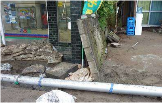
都：ブロック塀が隣の建物に寄りかかっている。道路際のブロック塀の倒壊は人的被害につながる可能性が高く注意が必要である。
