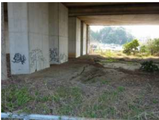
高速道路橋脚下の亀裂・段差と噴砂。
