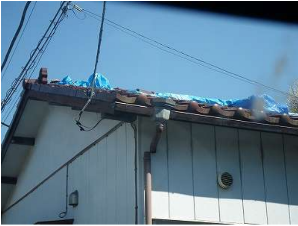
屋根瓦の被害。
