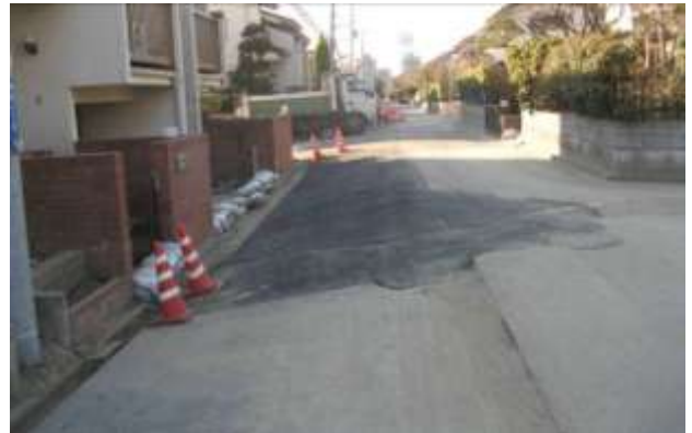
家屋が周辺とともに 1m 弱沈降した。今後の降雨での排水不良が懸念される。
