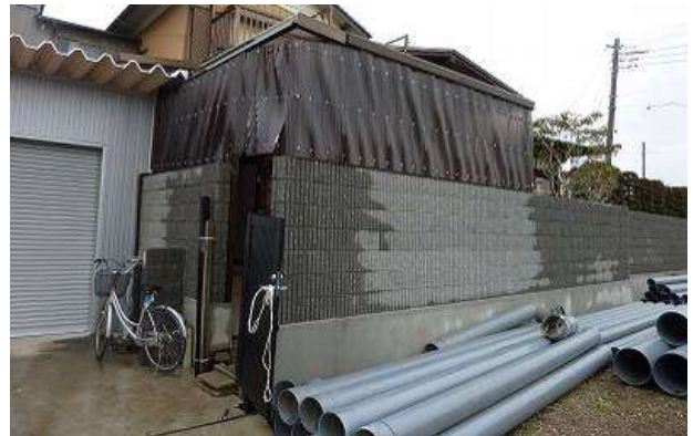
都：写真中央部分の亚克力製の波板は、斜めにしわがよっている。波板は中央の手前のブロック塀と奥の家屋と連結しているため、両者の変異の違いを受けこのようなしわがよったものと思われる。
