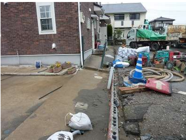
都：前写真の遠景。家屋、家屋敷地及び道路面がそれぞれ異なる変動をしている。そのため配管類が破損している。
