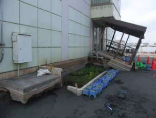
建物が抜け上がり地面との段差が生じ傾いてしまった通路。
