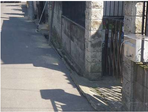
山側から低地側へ家屋の土地が移動し、側溝上部が狭まっている。同様な現象が、左側の側溝も見られた(近景)。
