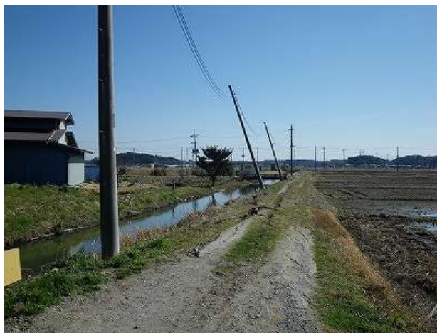
水路沿い農道の亀裂と電柱の傾き、周辺の水田には噴砂。
