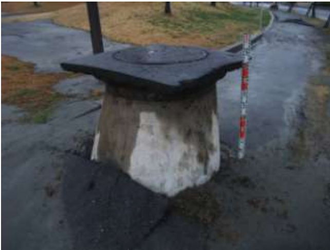
浦安市明海・高洲：浮き上がったマンホール。
