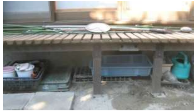
支柱が土台からずれている。液状化と地震動による建屋の傾動もみられる。
