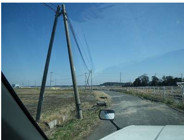
農道の地波と水田の噴砂及び電柱の傾き。
