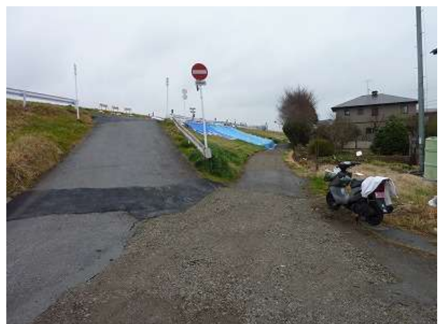
都：堤防に上る道路の破損と堤防の損壊。写真右手が被害住宅地域。
