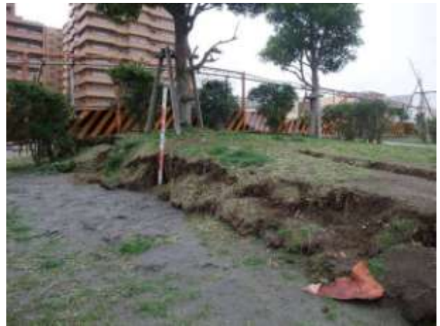
浦安市明海：落差40cmほどの直線上の断裂が認められた。断裂の上盤側は変形も小さいが、下盤側（北西方向）は著しい液状化現象が認められる。この断裂は約1kmにわたって追跡できる。
