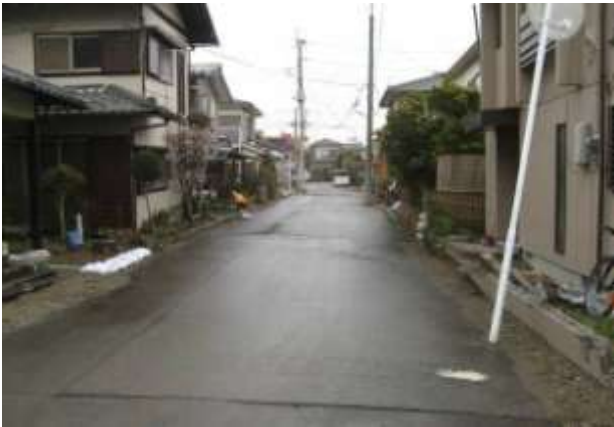
布佐酉町：噴砂や電柱・ブロック塀・家屋の傾動・沈降、地波といった深刻な液状化・流動化被害がみられる。家屋の中には1m以上沈降しているものもある。50軒以上の家屋の傾き・沈み込みがみられる。道路の変形と家屋・塀の傾き。
