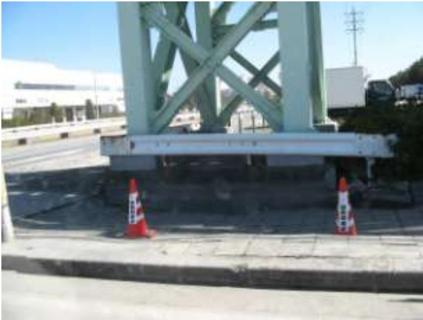
液状化による地盤の沈下の結果、杭基礎が入っていると思われる構造物では 40cm 程度の抜け上がりがみられる。
