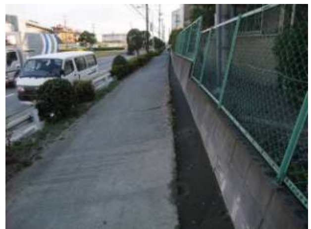
顕著な噴砂・抜け上がり・地盤沈下が認められる。
