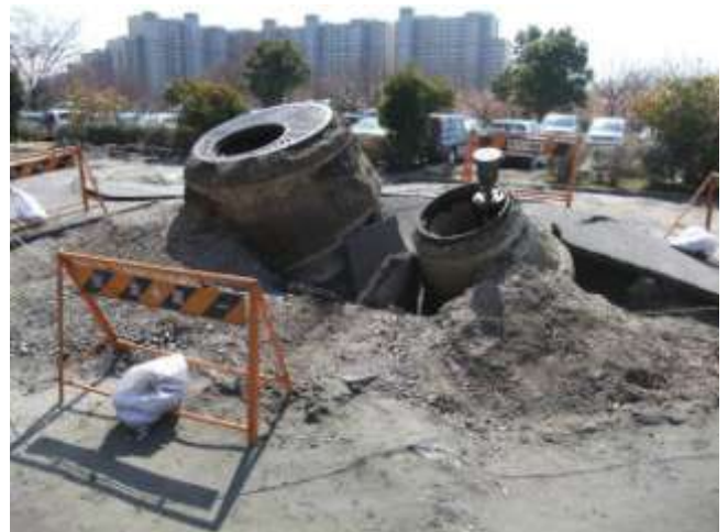
浦安市明海・高洲：浮き上がった地下埋設物。
