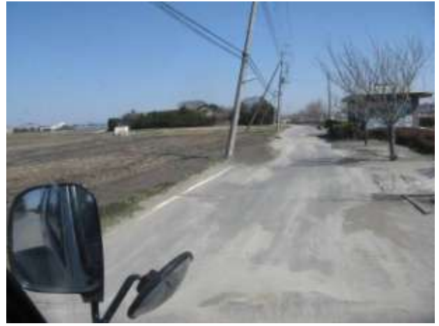
神崎町小松：旧河道よりも北側でも旧河道に平行に亀裂が走りここからの噴砂がみられる。また、地波、電柱の傾き・沈み込みがみられる。
