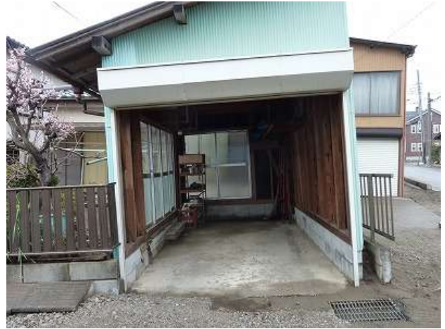
都：駐車場建屋の沈下・傾動。
