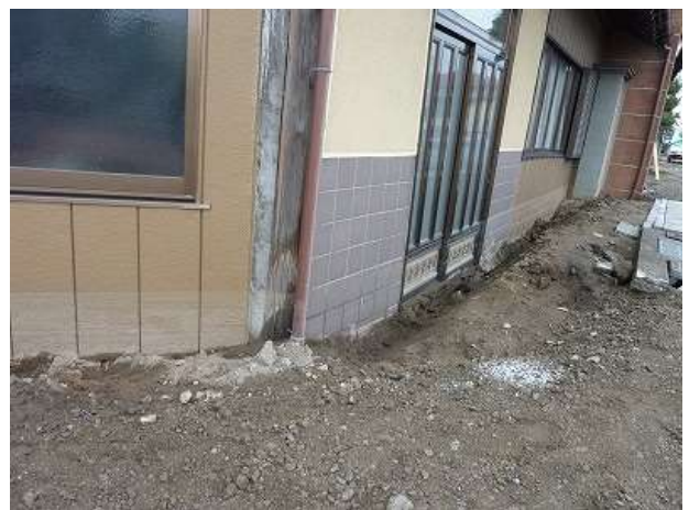
都：沈み込んだ家屋と家屋を取り囲む多量の噴砂。家屋の壁に噴砂の跡が残っているのが見える。
