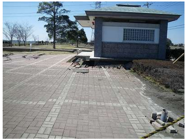
小水路沿いの公園に作られた便所建屋の抜け上がり50cm以上。
