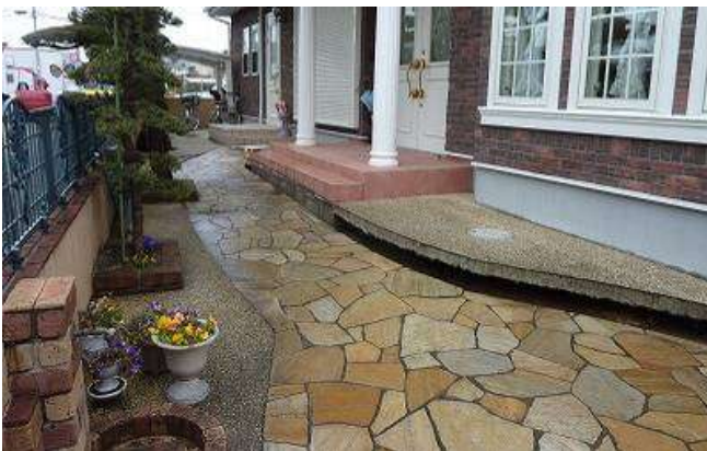
都：前写真の玄関部分を液状化地域側から見た。奥が液状化していない地域（境界は写真と平行方向）、写真
