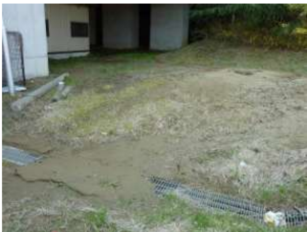
高速道路橋脚下の噴砂。
