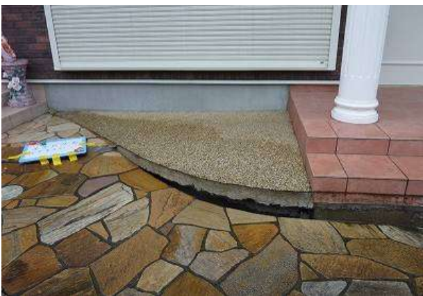
都：一軒の敷地内を液状化—流動化している部分としていない部分との境界がとおる（境界線は写真とほぼ直行方向）。玄関前の敷石をみると、左側部分は液状化していないため玄関敷石が玄関部分と密着しているが、右側部分は液状化のため地表面が大きく沈降し、玄関敷石が玄関部分を離れて落ち込んでいる。
