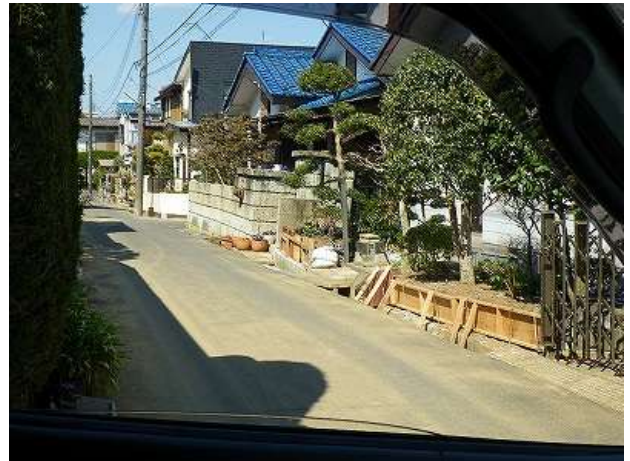
中央左の家屋塀の傾き及び手前家屋の塀は転倒し修復中。
