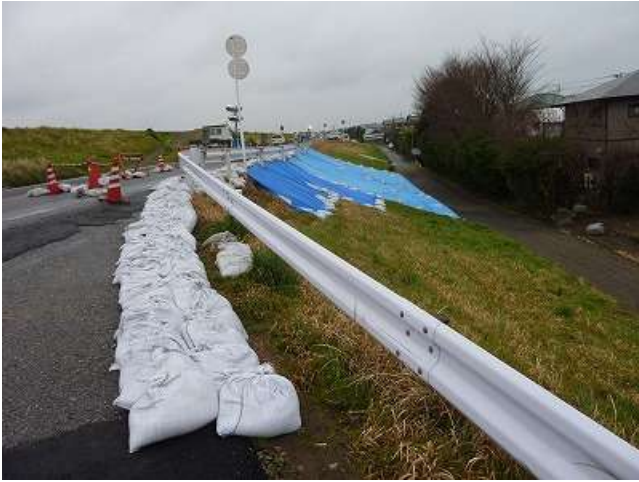
都：堤防の損壊。写真右側が被害住宅地。
