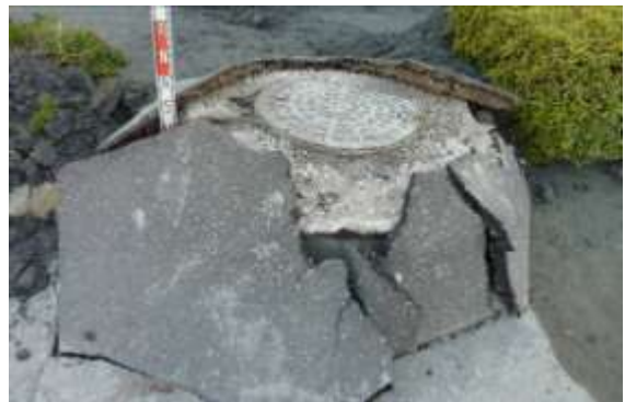
U-2 浦安市での噴砂とマンホールの浮上
