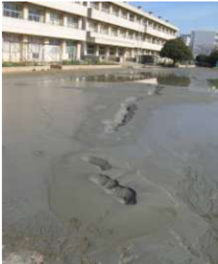
C 帯-2 高浜 4 丁目高浜三小 大規模な亀裂に伴う噴砂と沈下でできた水たまり
