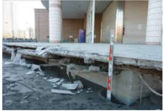
U-1 浦安市での噴砂と地盤の沈下による抜け上がり
