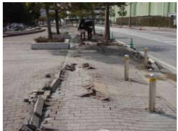
F 帯-1 海浜幕張駅周辺での噴砂と地表の変形
