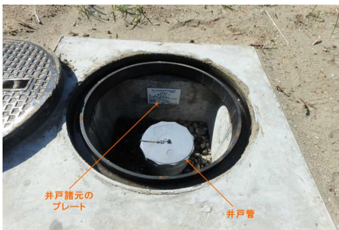
図Ⅱ-28 設置された地下水観測井の例
