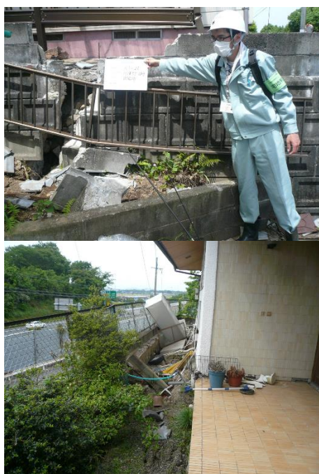
図一⑮-4 熊本地震における判定状況写真
