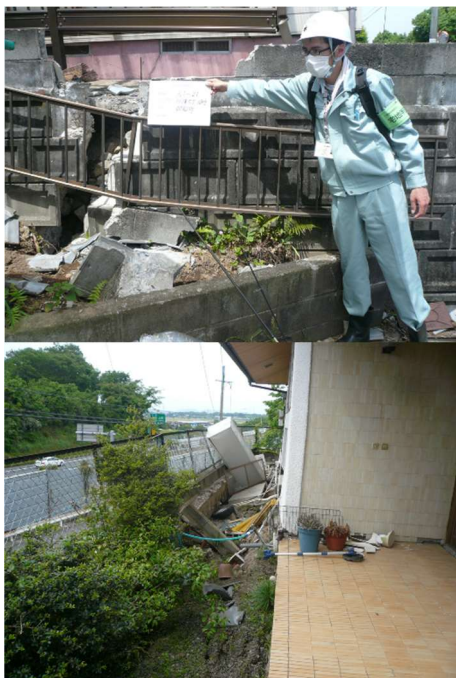
図一⑯-4 熊本地震における判定状況写真
