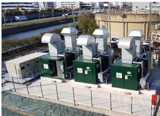
汚泥消化ガス発電事業 (船橋市 西浦下水処理場)
