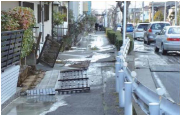
埋立地の多い本県では、液状化現象が発生しやすい。 (写真:習志野市/ 東日本大震災)
