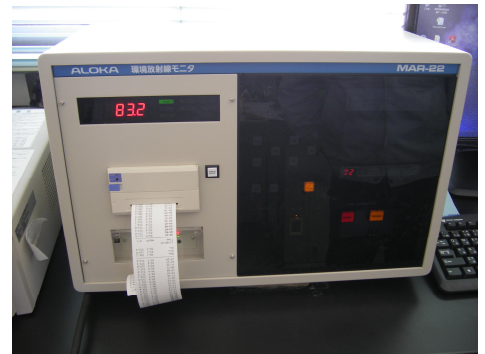
写真5-1 モニタリングポスト計測部
