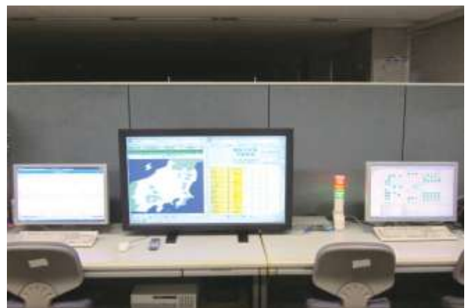
監視システム室
