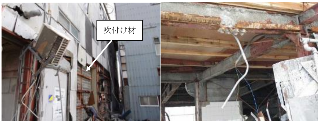
吹付け材が露出している例
