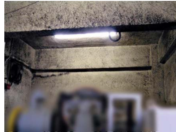
機械室吸音材
