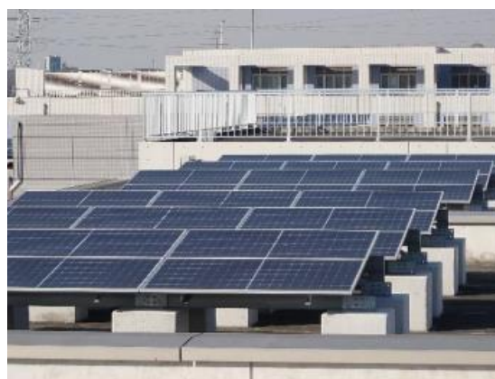
太陽光発電設備
