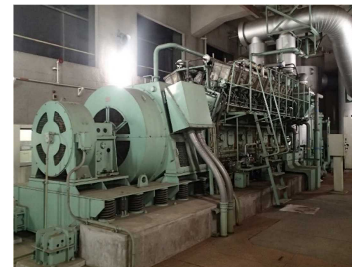
非常用自家発電設備
