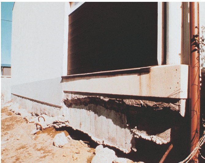
まわりの地盤が沈下して、建物の基礎があらわれた (1973(昭和48)年 浦安市)
