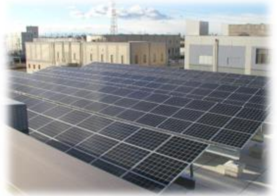
ちば野菊の里浄水場太陽光パネル
