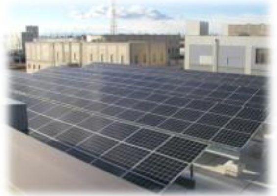
ちば野菊の里浄水場太陽光パネル
