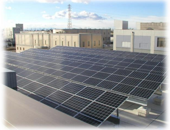
ちば野菊の里浄水場太陽光パネル
