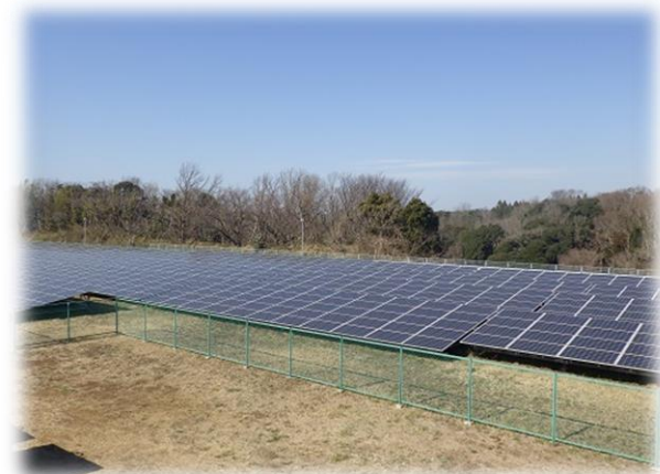
袖ヶ浦浄水場メガソーラー
