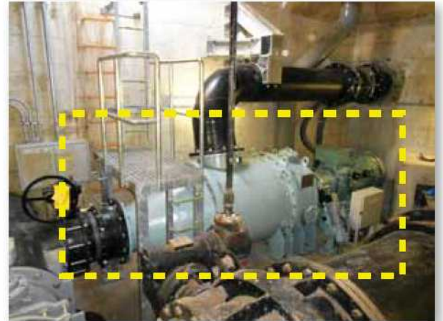
北船橋給水場の1号機マイクロ水力発電装置
