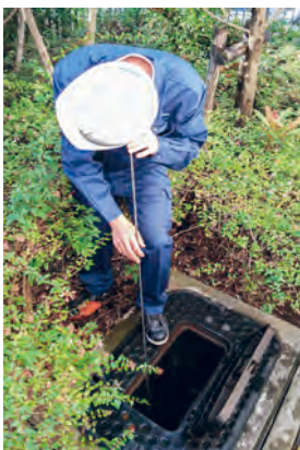
漏水調査：水道管から伝わる音だけをたよりに漏水を見つけます。
