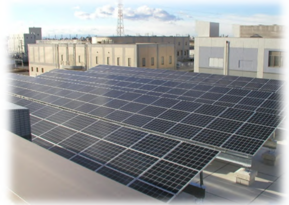
ちば野菊の里浄水場太陽光パネル
