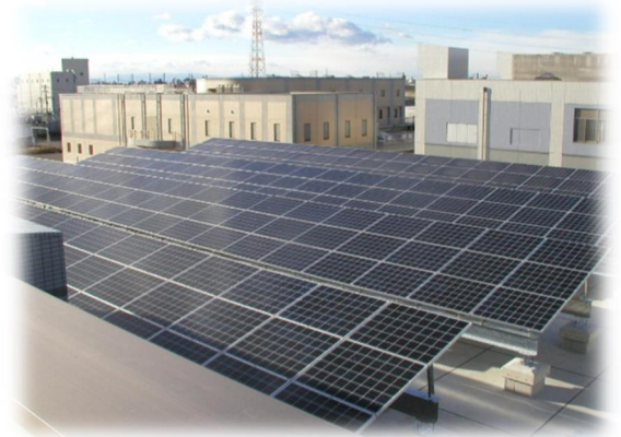
ちば野菊の里浄水場太陽光パネル
