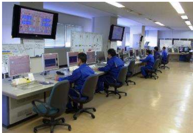
浄水場の管理室の様子
