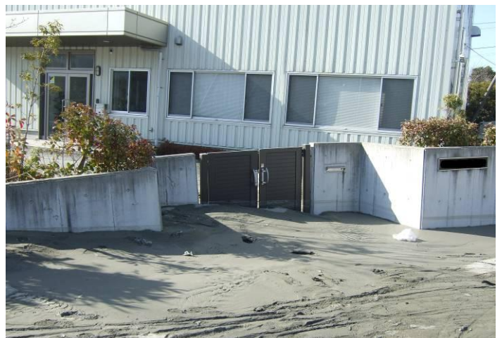
噴出した砂に埋もれた塀
