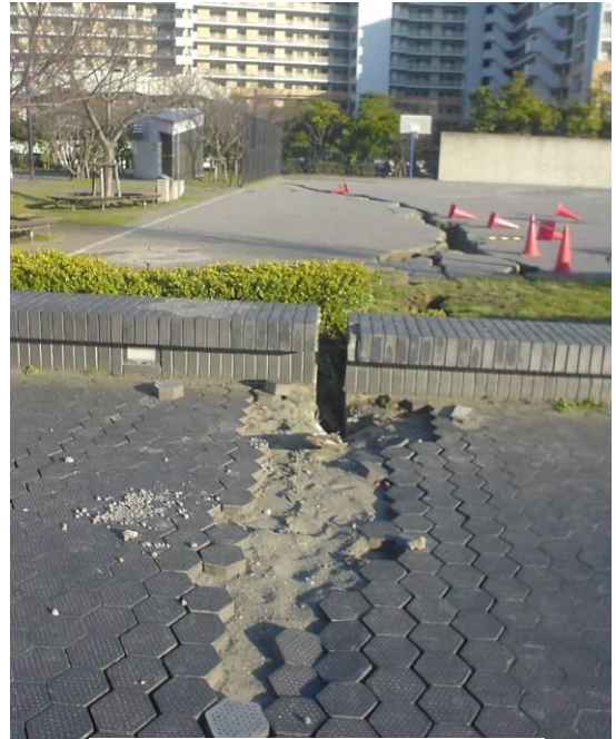
地割れが発生し、ブロックを寸断
