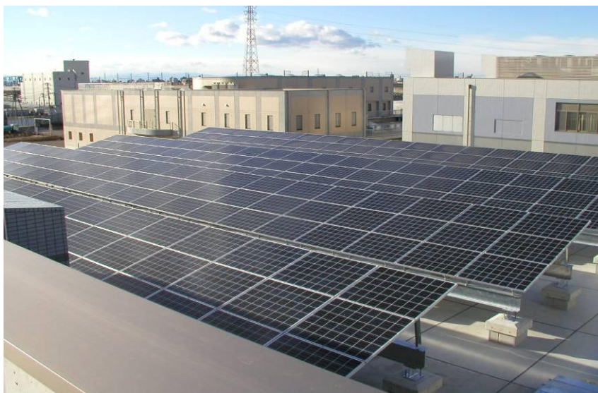
太陽光発電パネル（ちば野菊の里浄水場）
