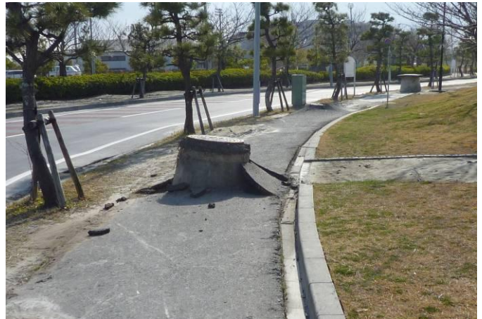
液状化現象のため浮き上がった、歩道沿いに埋設されていたマンホール（右奥にもあり）
