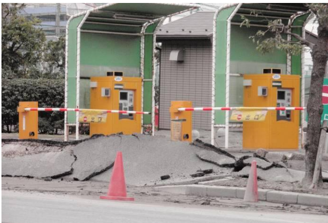
地盤隆起による、歩道の破損
