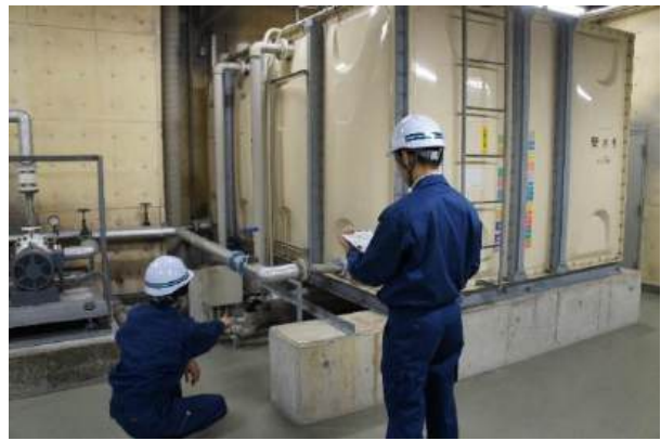
貯水槽水道地域巡回サービス
