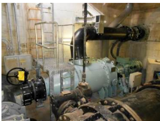
マイクロ水力発電設備
