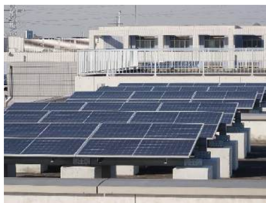
太陽光発電設備
