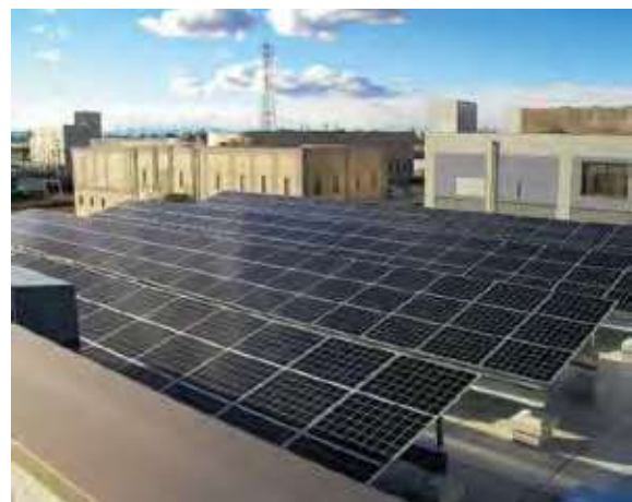
図5-17 太陽光発電設備（ちば野菊の里浄水場）
