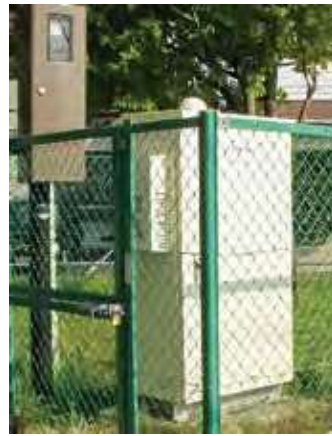
図5-10 水質自動監視装置
