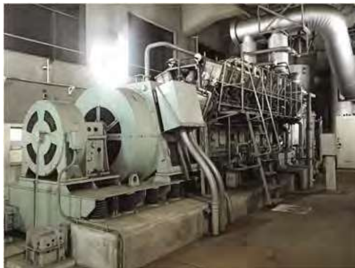
図5-3 非常用自家発電設備
