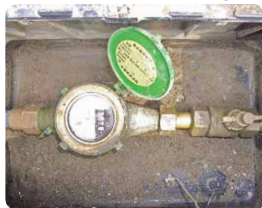
水道メーター
