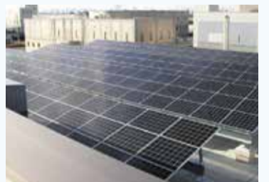
太陽光パネルの設置(ちば野菊の里浄水場)
