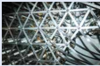
写真5 オゾン発生処理装置の内部
