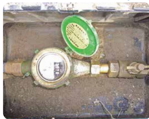
水道メーター
