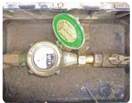
水道メーター
