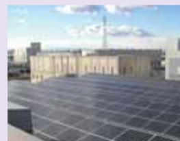
▲太陽光発電設備 (ちば野菊の里浄水場)
