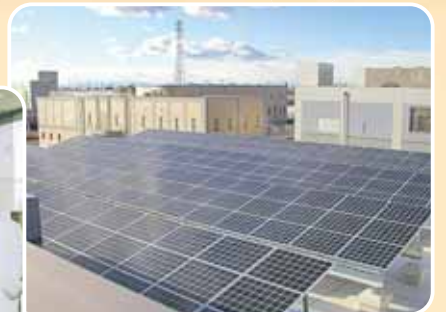
太陽光発電装置(ちば野菊の里浄水場)
